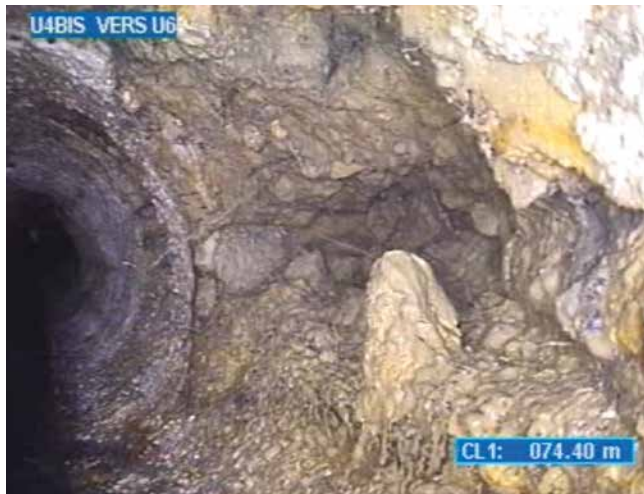
Effondrement partiel du collecteur existant.
