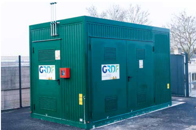
Poste d'injection du biométhane dans le réseau gaz de ville.
