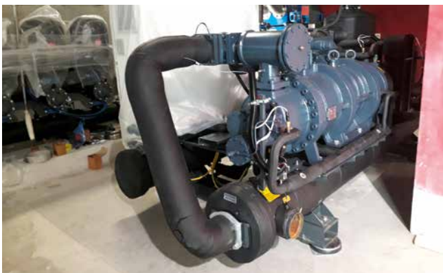
Pompe à chaleur.
