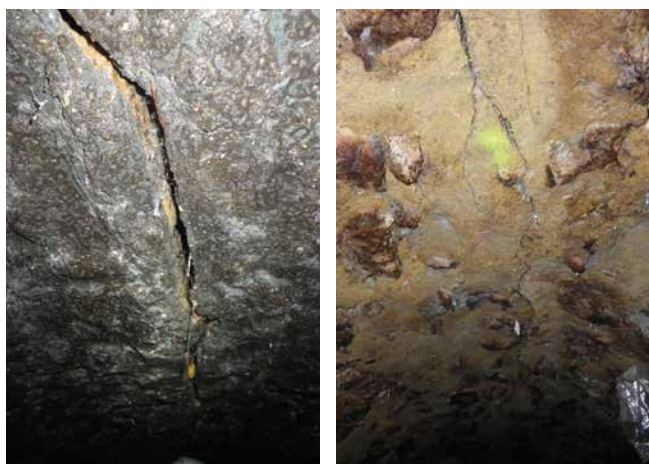
Vue de la fissuration en voute vers R24 & R50.
