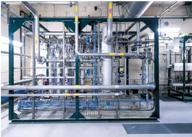
Unité de traitement du biogaz en biométhane.
