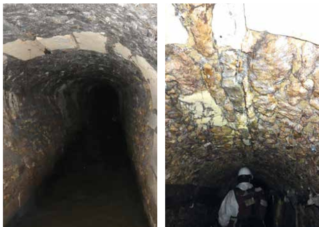
Vue de la déformation de l'ouvrage et de bombement du piédroit gauche à proximité de R25 et de R26.
