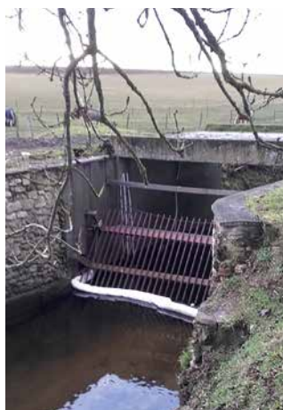
Dégrillage au niveau du bassin de Rennemoulin.
