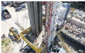
Exemple de forage réalisé sur le réseau de chaleur d'Engie Réseau à Villegriette. © ENGIE RESEAU
